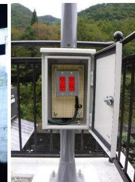
非常用コンセント(右)
